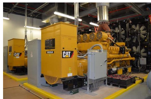
Открытое исполнение ДГУ. Используется в помещениях
