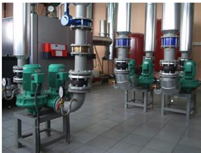
Рис. Насосы на фундаментах
