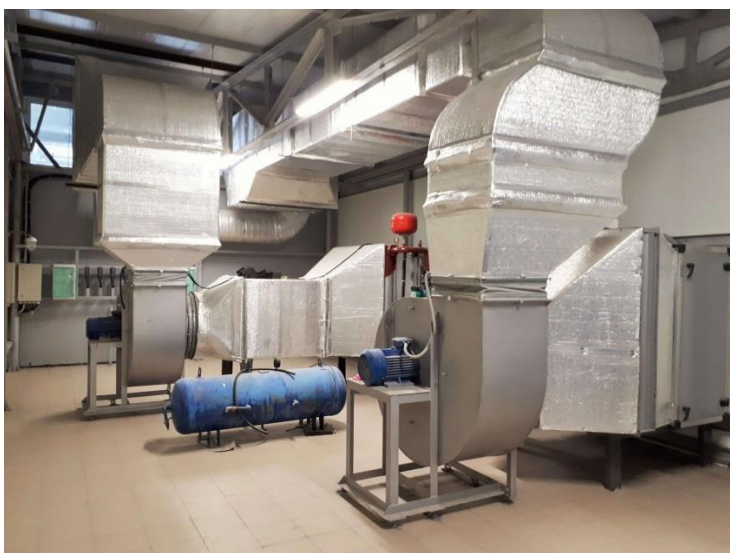
Рис. Отдельные вентиляторы также устанавливаются прямо на пол венткамеры, но через виброизоляторы
