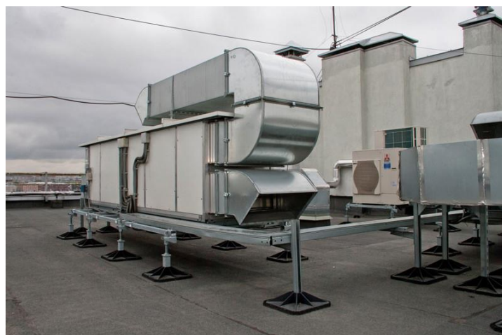
Рис. Использование big foot для размещения вентоборудования
