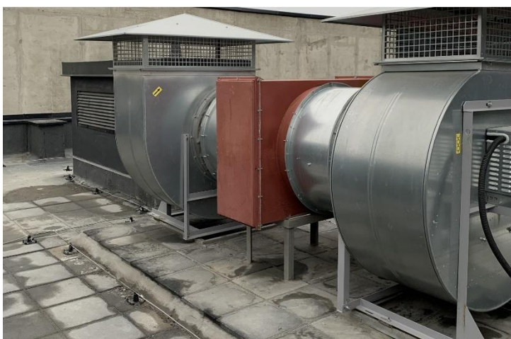
Рис. Площадка под вентиляторами для защиты кровли
