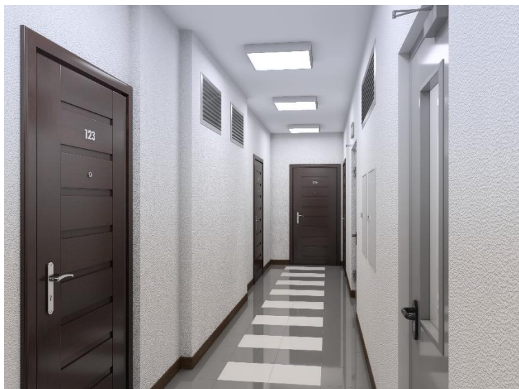
Рис. Решетки (точнее, клапаны) дымоудаления находятся немного выше эвакуационных дверей. В данном коридоре установлены сразу несколько решеток
