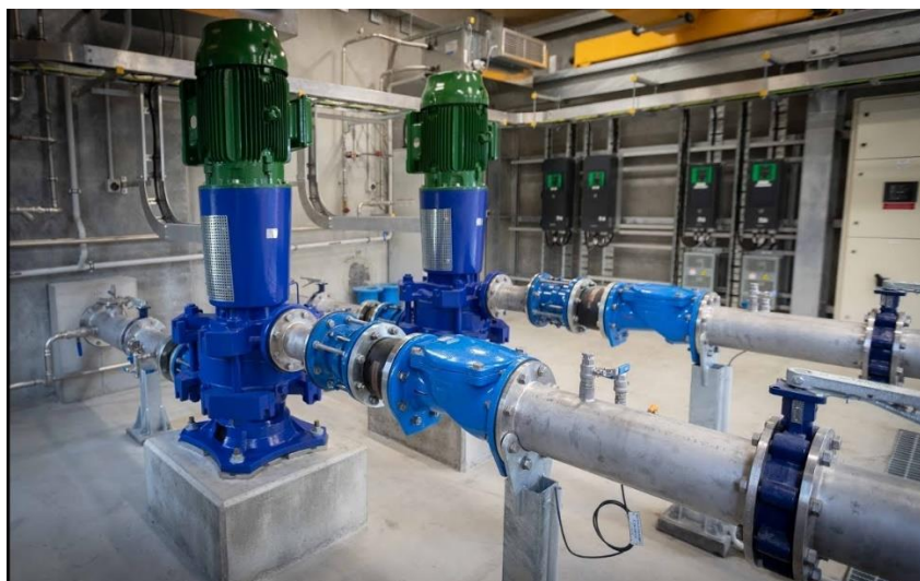
Рис. Под насосное оборудование обычно устанавливаются бетонные фундаменты
