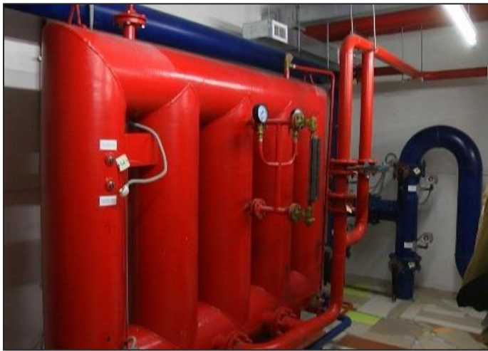
Рис. (↑) Автоматический водопитатель (гидропневмобак) для системы АПТ с обвязкой.
