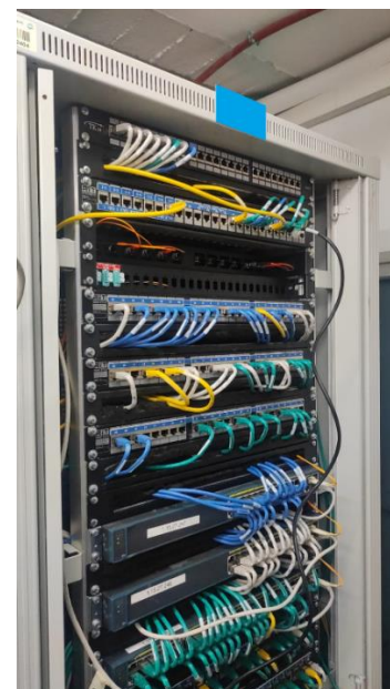
Рис. В шкафах размещаются коммутаторы и вспомогательное оборудование
