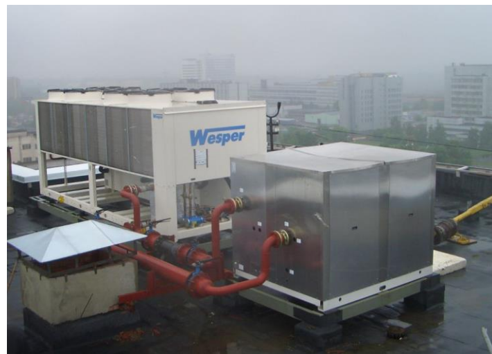
Рис. Слева – чиллер, справа – гидромодуль наружного исполнения
