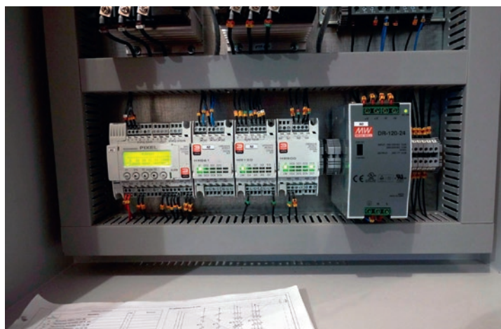
Рис. 4. Шкаф автоматизации с контроллером (левый нижний элемент)
