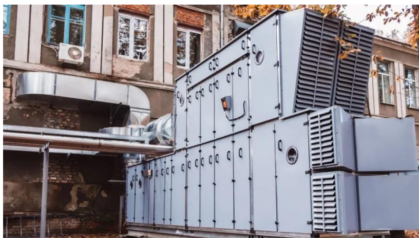
Рис. «Большая» приточно-вытяжная установка
