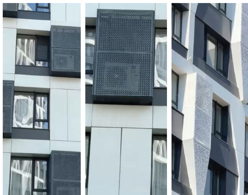
■ Рис. 2. Корзины, закрытые фасадными панелями. Декоративные пилоны для наружных блоков
