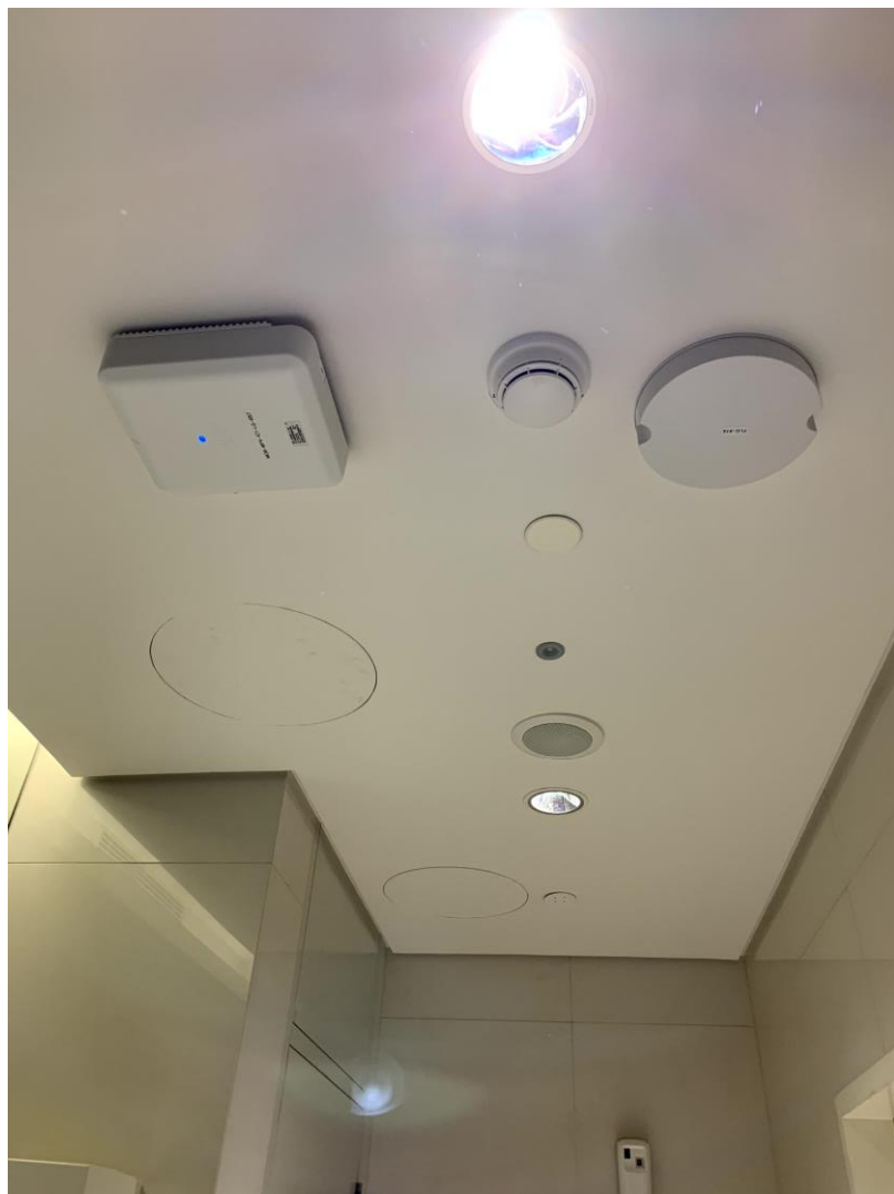
↑ Датчик пожарной сигнализации и мощный светильник разнесены на рекомендуемое расстояние, чтобы избежать ложного срабатывания
