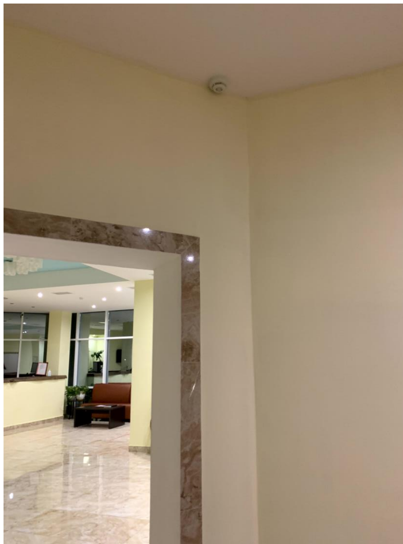
↑ Датчик пожарной сигнализации прямо в углу – так устанавливать не рекомендуется
