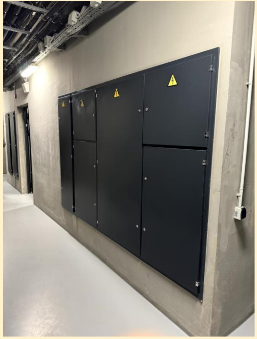
← Двери и лючки доступа к нише и шахтам электроснабжения квартир, а также шахтам транзитных кабельных трасс
