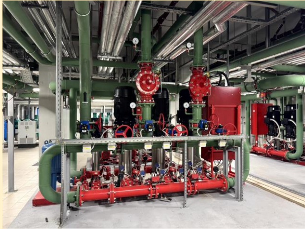
Помещение насосной на техническом этаже
